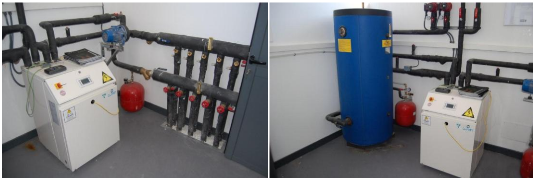
Figura N° 11 Sala de maquinas.
